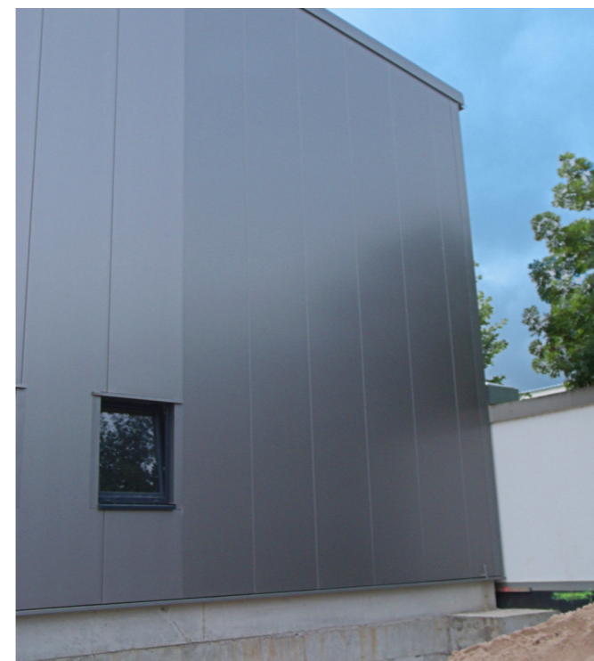
Changements de couleur involontaires entre les panneaux sandwich isolés en mousse et en laine de roche
