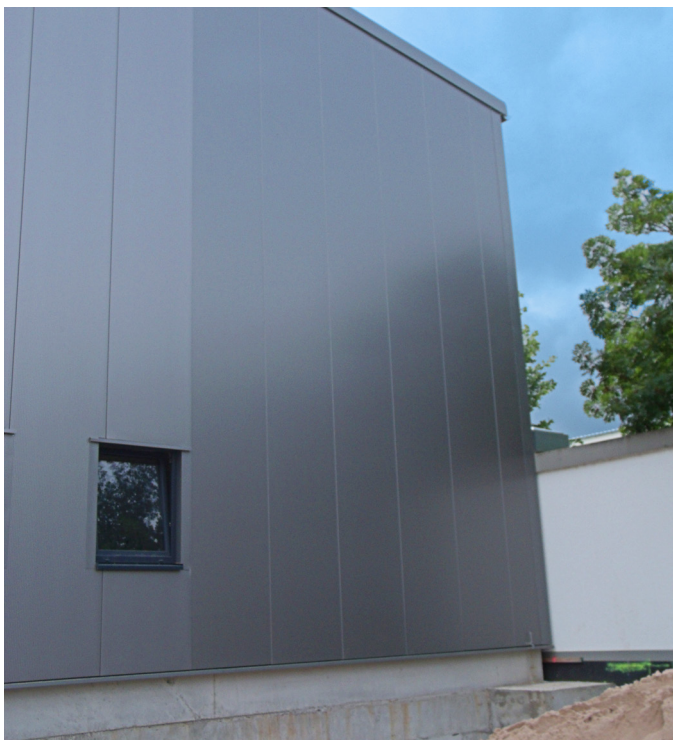
Cambiamenti involontari di colore tra pannelli sandwich in schiuma e in lana di roccia
