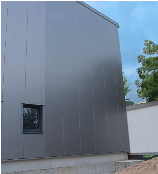
Cambios de color involuntarios entre los paneles sándwich espumados y de lana de roca
