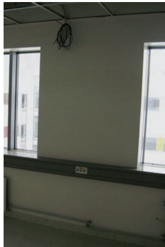
Figur 14. Bildet viser innvendig overflate for en yttervegg der det er benyttet tynnplateprofiler som ikke er slisset.
