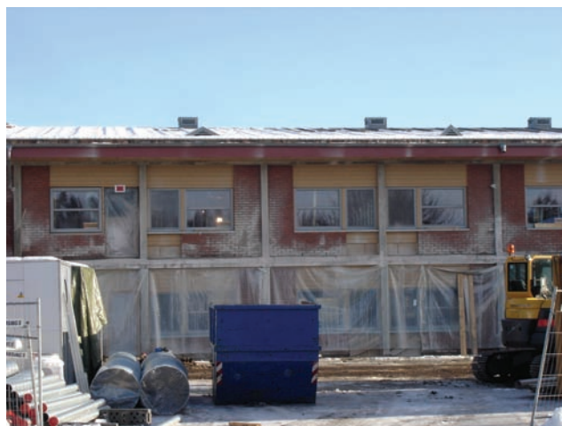
Figur 9. Dette bildet viser gjennomgående betong i en tegl/tre fasade.
