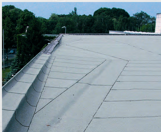
Punktentwässerung entlang der Attika
