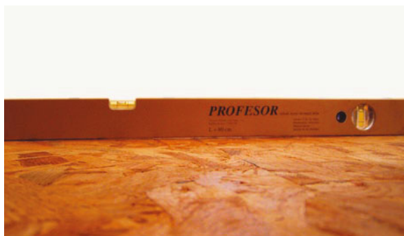
Ukázka průhybu podlahy (obr. 46)
