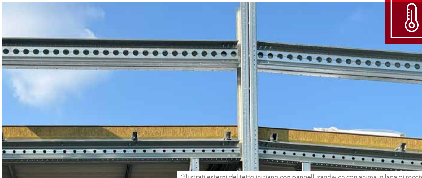
Gli strati esterni del tetto iniziano con pannelli sandwich con anima in lana di roccia
