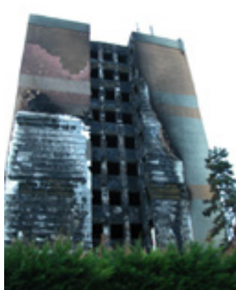
Figura 14. Conseguenze dell'incendio dell'ostello di Dijon [20]
