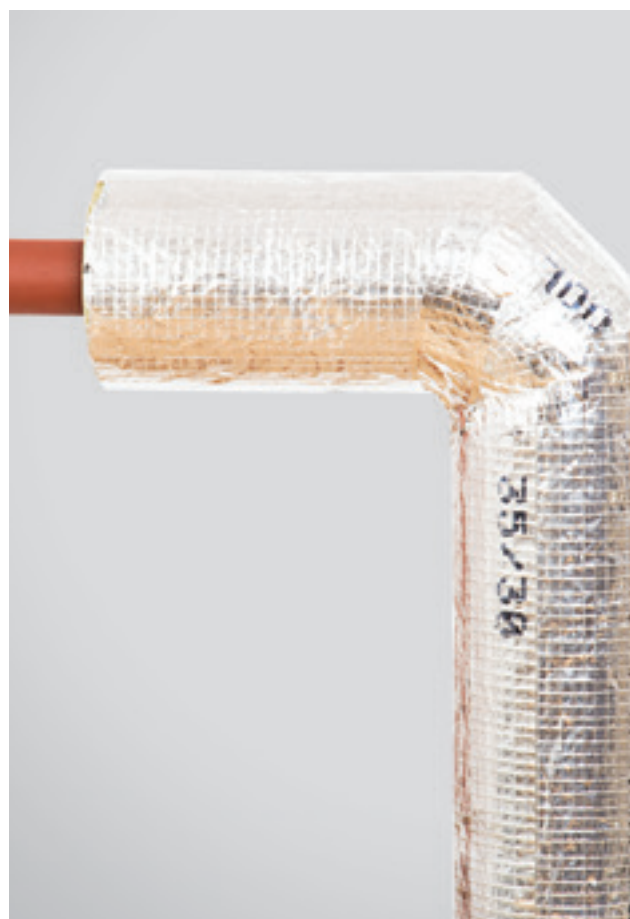
8. Ar ROCKWOOL 800 čaulu izolēts caurules līkums ar vienu līkumadaļu
