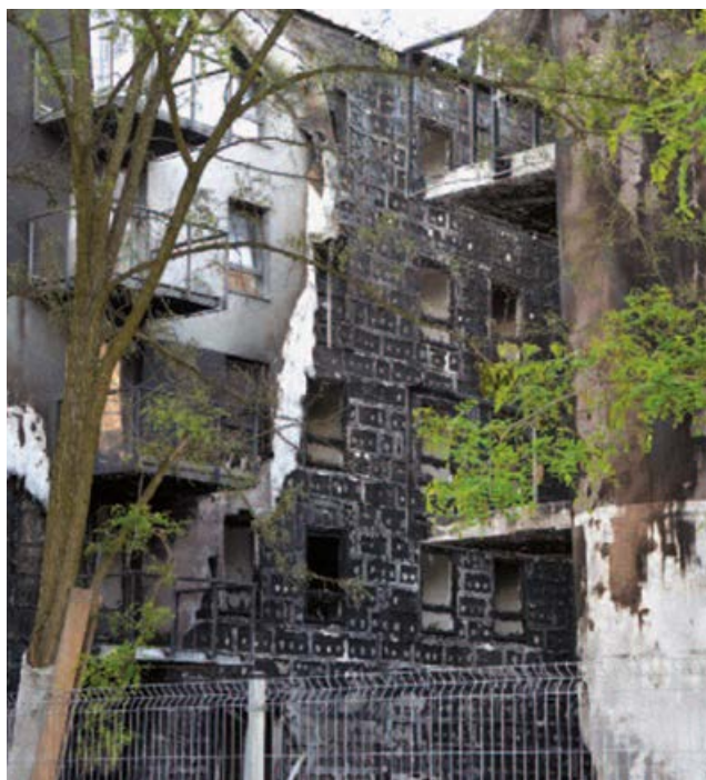
Po ociepleniu elewacji prawie gotowego do oddania do użytkowania budynku rozprzestrzenił się pożar. Usuwanie jego skutków zajęło 5 miesięcy. Niezbędny był remont większości spośród ponad 100 mieszkań, w tym wymiana stolarki.
